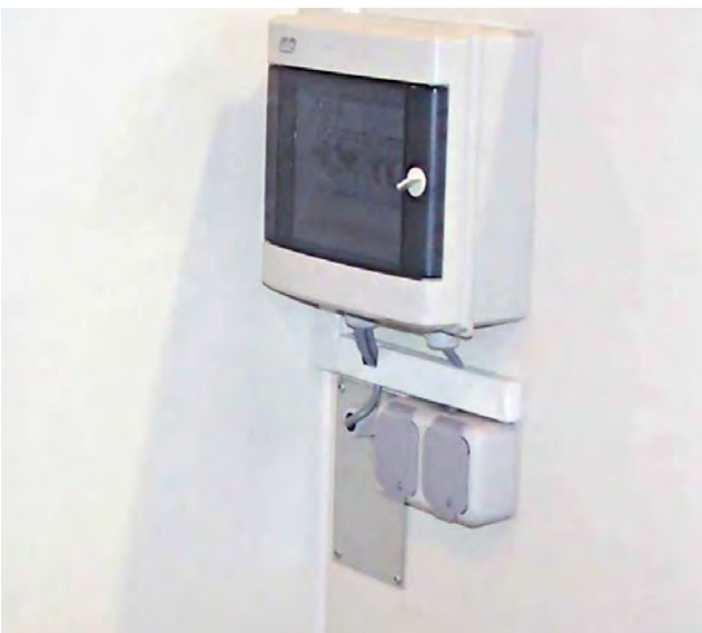
Verteilerkasten mit FI und Sicherungen
